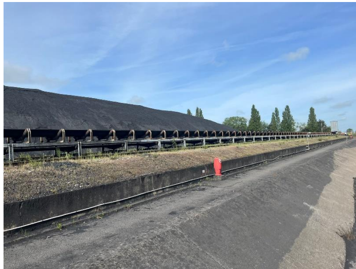
Figure 26 : Poteau incendie du parc à charbon
